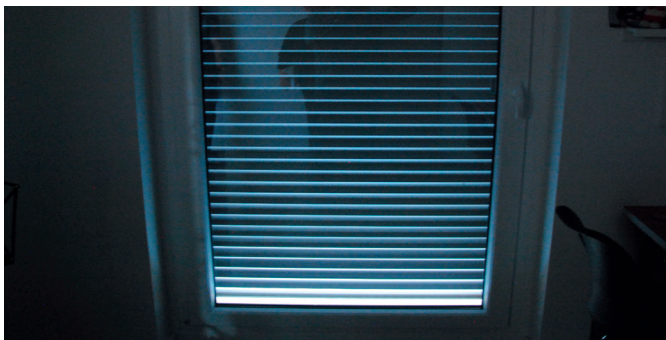
Afbeelding 14: Indirecte lichtinval via de vensterbank. Hier zit het pantser van het rolluik op de eindkappen van de geleiderails. Dit ontwerp was vooraf contractueel overeengekomen.
