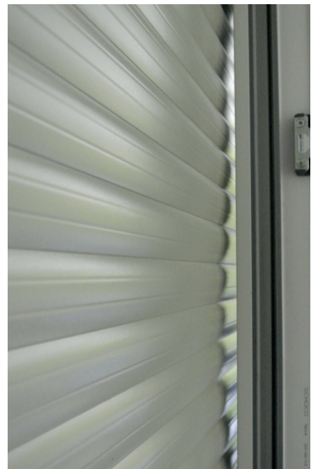
Afbeelding 30: Een rolluikblad dat uitpuilt. De lamellen van het rolluik bollen naar voren uit.
