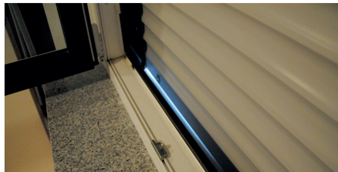
Afbeelding 15: Lichte indirecte lichtinval via de vensterbank. Dit komt door de aard van het onderliggende oppervlak. De vensterbank is niet horizontaal geïnstalleerd.
