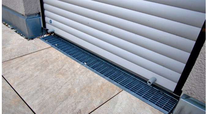
Afbeelding 3: De vloerbedekking en afwateringskanalen werden omgevormd tot een horizontale steun voor het rolluikgordijn. De vloerbedekking en de afwateringsgoot werden later geïnstalleerd.
