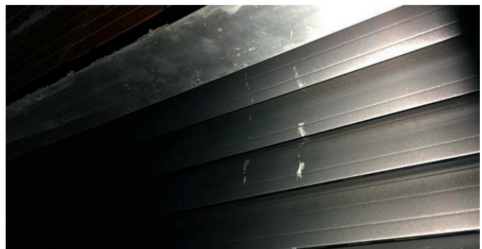
Afbeelding 27: Op de bovenste lamellen zijn duidelijk diepe krassen te zien, veroorzaakt door een braam of iets dergelijks. Dit is niet toegestaan.
